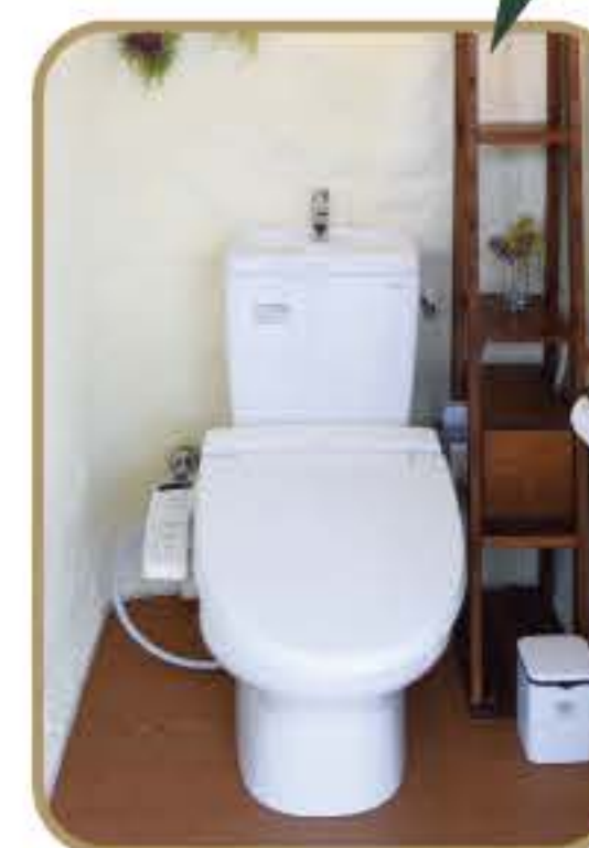
温水洗浄便座付き便器
