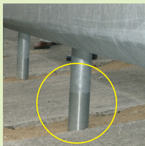
ガードレール支柱地際部
