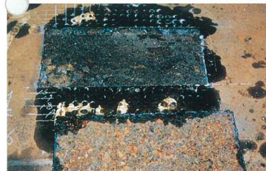
腐食したアニュラー部の裏面
