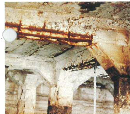
コンクリート剝落、鉄筋露出
