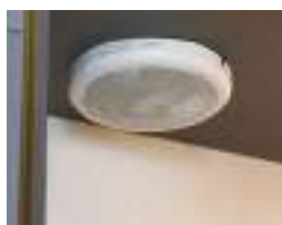
排気用換気ファン
