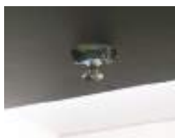
自動消火装置
