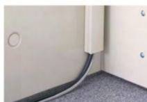
床配線用ダクト
