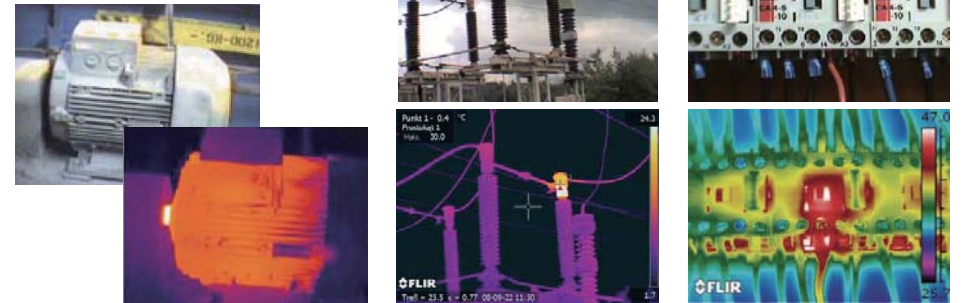
プラント内モーター温度監視
