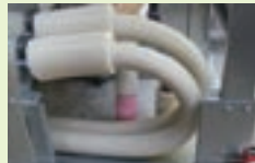
貯湯タンクユニット下
