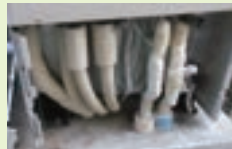
貯湯タンクユニット下
