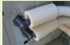
ヒートポンプ接続部
