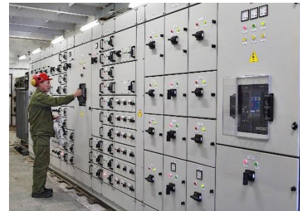
受変電設備異常検知
