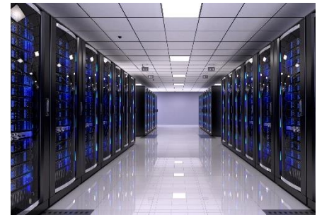
サーバールーム温度監視
